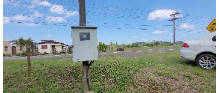
Figura 70: Macromedidor do bairro Mãe Luzia.
