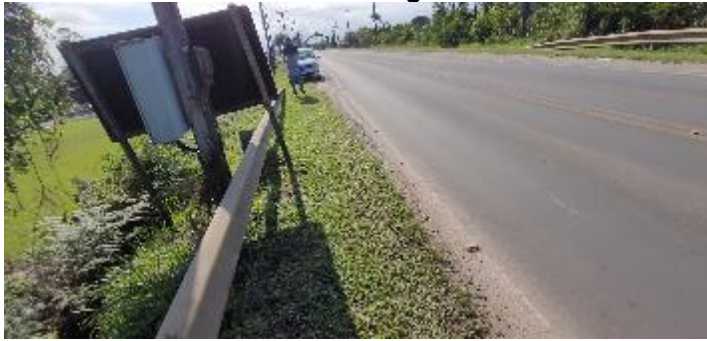
Figura 83: Macromedidor Rio Sangão – Rodovia Gabriel Arns – visão geral.
