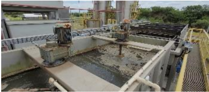
Figura 129: ETE Forquilha – Floculadores mecânicos.
