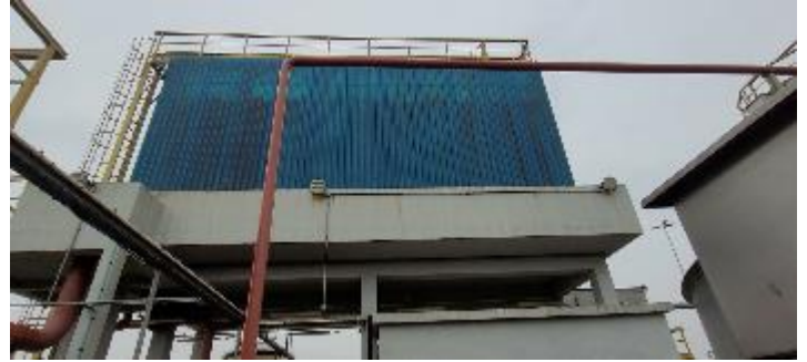
Figura 136: ETE Forquilha – Filtro Biológico.
