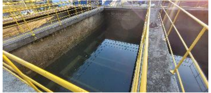
Figura 33: ETA São Defende – Filtros.
