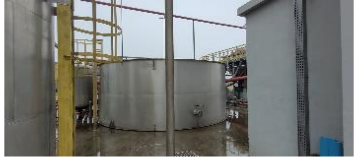
Figura 144: ETE Forquilha – Tanque de contato.
