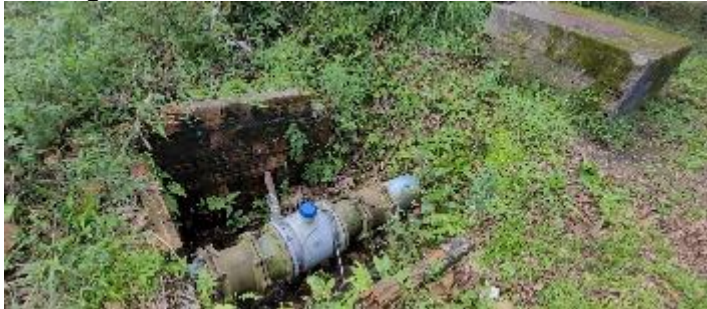
Figura 69: Macromedidor do bairro Mãe Luzia.
