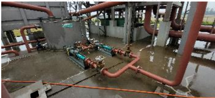
Figura 154: ETE Forquilha – arranjo hidráulico – unidades de bombeamento.
