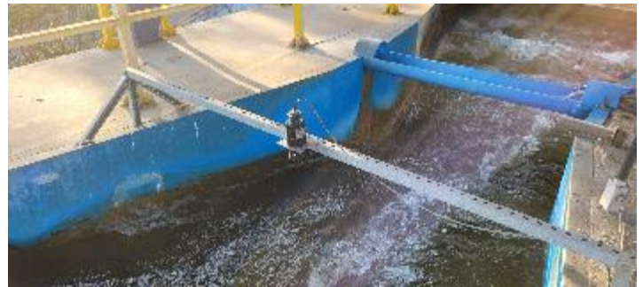
Figura 20: ETA São Defende - Sensor de vazão para telemetria.
