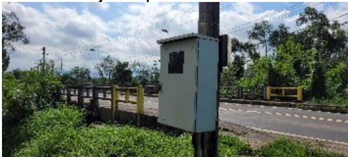
Figura 71: Macromedidor São Bento Baixo – localizado junto à ponte da SC443.
