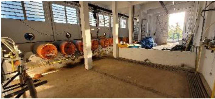
Figura 38: ETA São Defende - Casa de dosagem de cloro – Visão interna.
