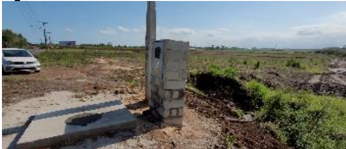
Figura 81: Macromedidor do Loteamento Nova Itália.
