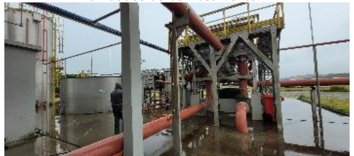
Figura 155: ETE Forquilha – arranjo hidráulico – unidades de bombeamento.
