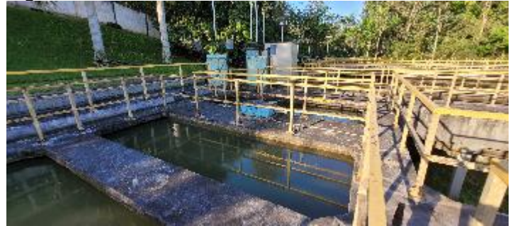
Figura 25: ETA São Defende - Floculadores mecânicos.
