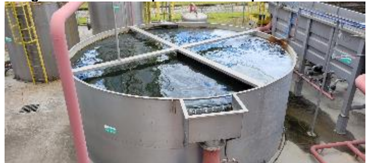
Figura 142: ETE Forquilha – Tanque de contato.
