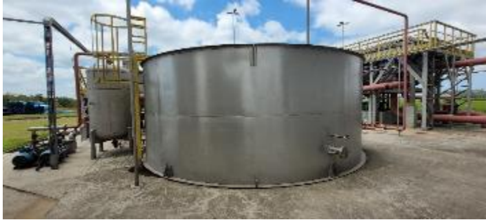
Figura 143: ETE Forquilha – Tanque de contato.
