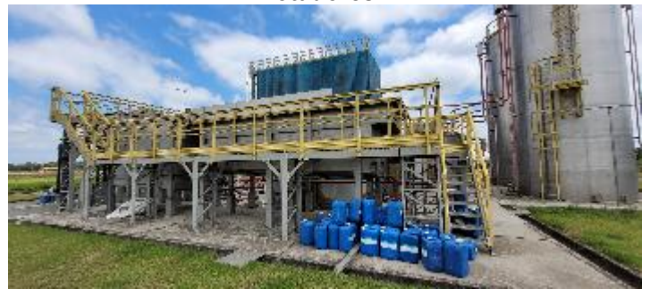
Figura 138: ETE Forquilha – Floculadores e flotadores.
