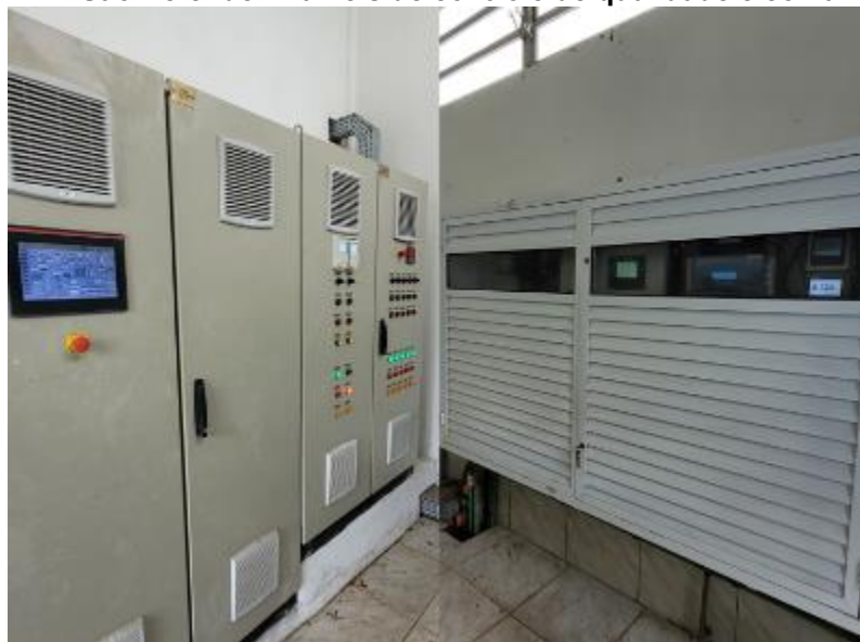
Figura 44: ETA São Defende - Painéis de controle de qualidade e comando elétrico.
