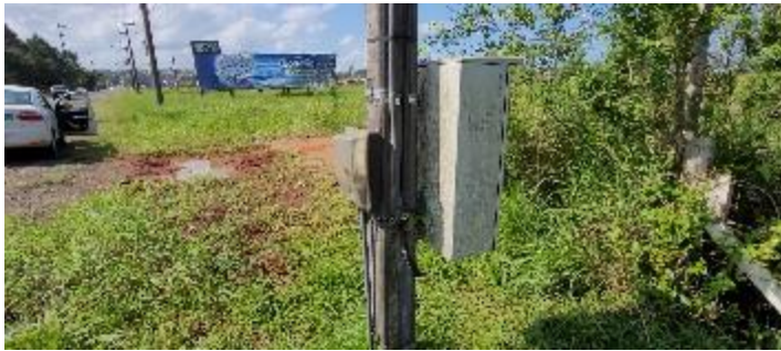
Figura 77: Macromedidor do bairro Santa Cruz – Rua Lucas Peruchi.
