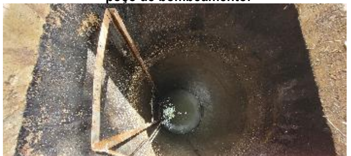
Figura 109: EEE13 Bairro Centro – Rod Jacob Westrup – poço de bombeamento.
