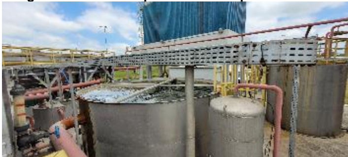
Figura 141: ETE Forquilha – Tanque de contato.
