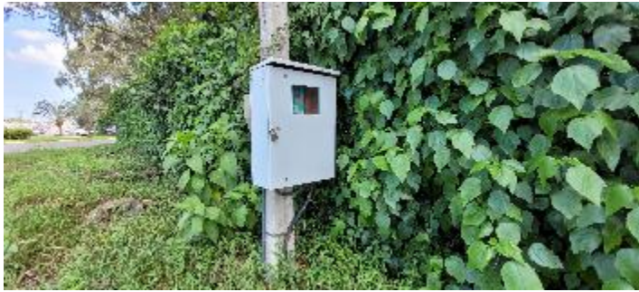
Figura 67: Macromedidor da Seara Alimentos - Av. 25 de Julho.
