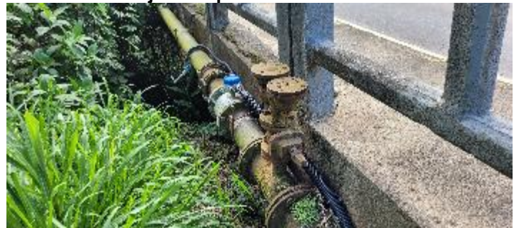
Figura 72: Macromedidor São Bento Baixo – localizado junto à ponte da SC443.
