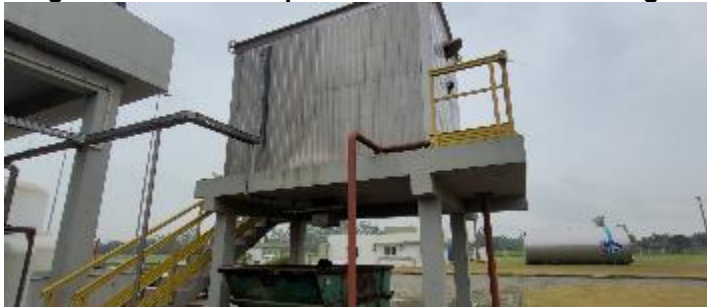
Figura 146: ETE Forquilha – Decanter centrífugo.
