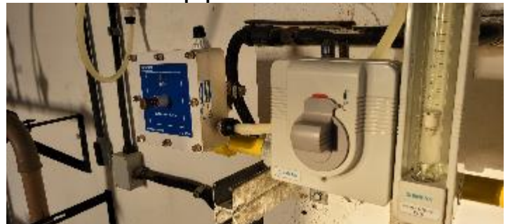
Figura 37: ETA São Defende - Casa de dosagem de cloro – Equipamentos de controle.
