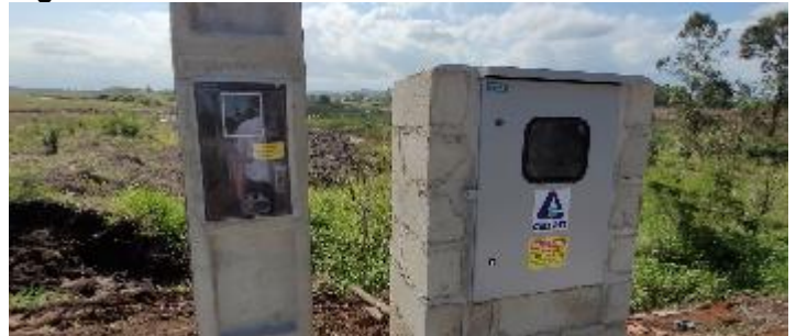
Figura 82: Macromedidor do Loteamento Nova Itália.
