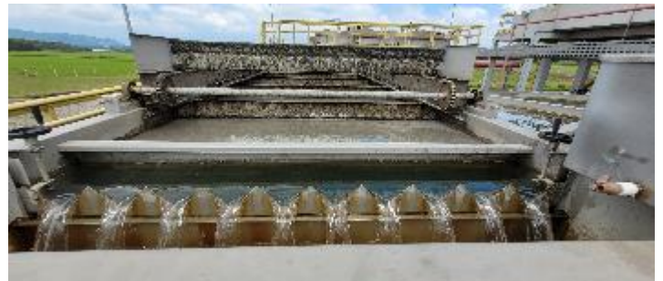
Figura 134: ETE Forquilha – Flotador - efluente clarificado.
