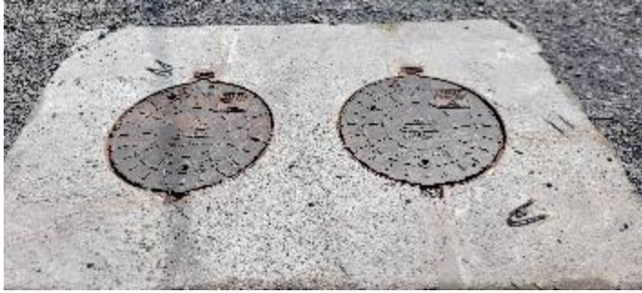
Figura 75: Macromedidor da Rua Lucas Peruchi.
