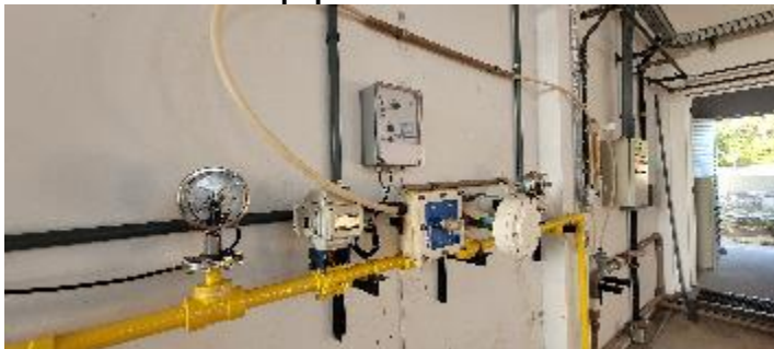
Figura 36: ETA São Defende - Casa de dosagem de cloro – Equipamentos de controle.
