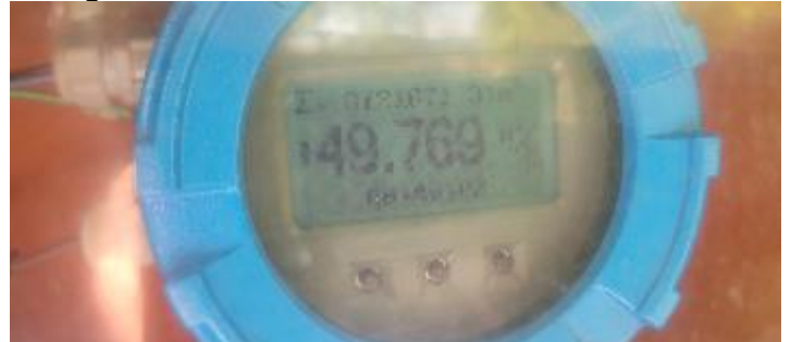
Figura 74: Macromedidor da Rua Lucas Peruchi.
