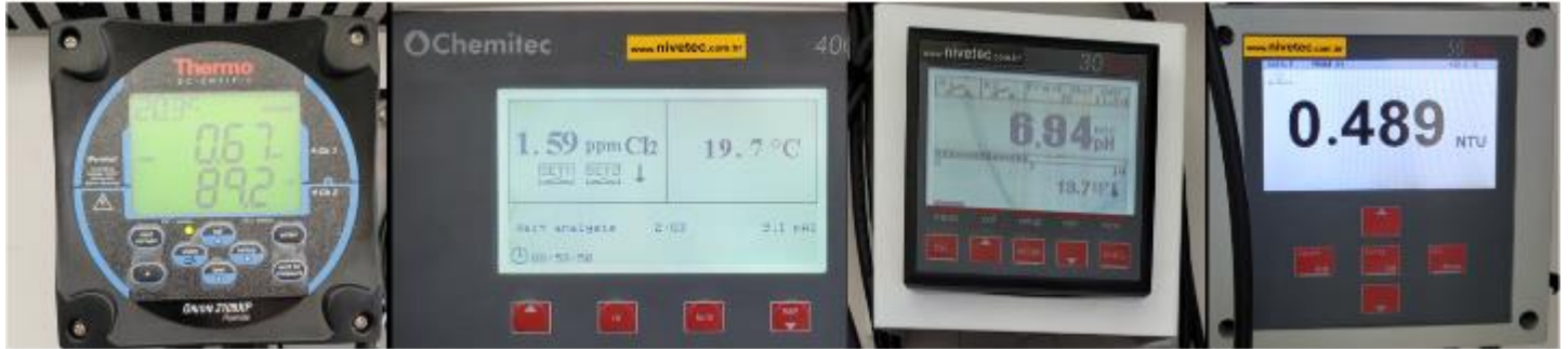
Figura 47: ETA São Defende - Displays dos instrumentos de qualidade de água – telemetria.
