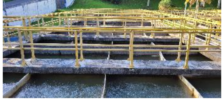
Figura 23: ETA São Defende - Floculadores hidráulicos.
