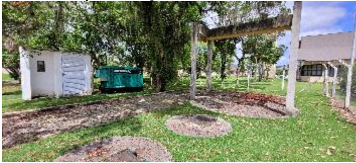
Figura 110: EEE13 Bairro Centro – Rod Jacob Westrup – ponte de içamento de bombas.
