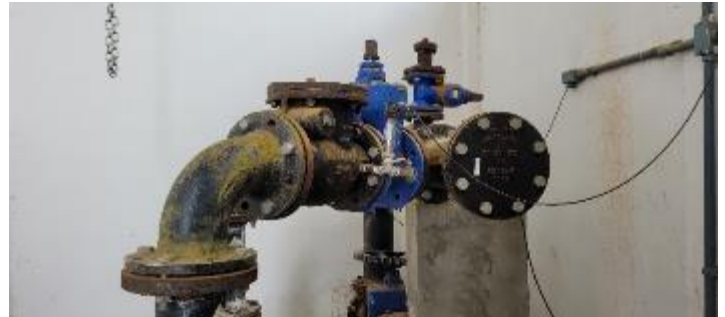
Figura 88: Booster Maracajá – Rodovia Jacob Westrup – Barriletes e válvulas.
