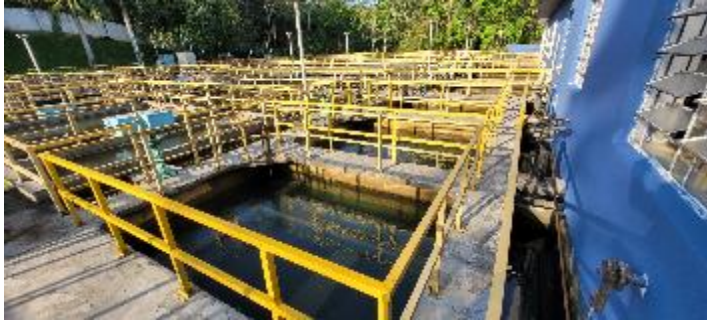
Figura 30: ETA São Defende – Filtros.
