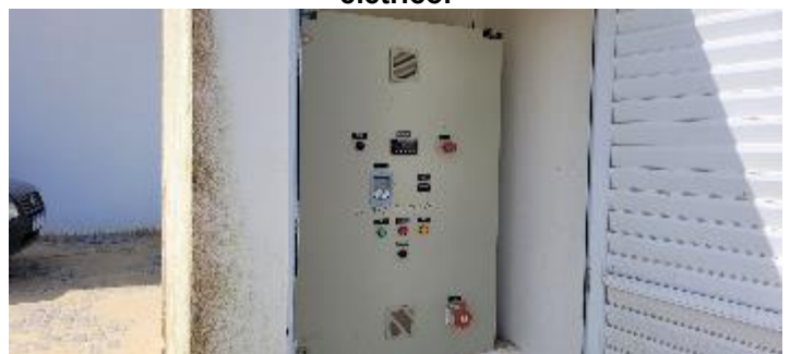
Figura 117: EEE07 Bairro Santa Clara - quadro de elétrico.
