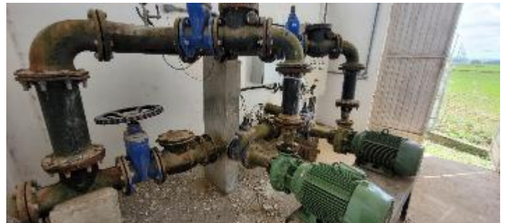
Figura 86: Booster Maracajá – Rodovia Jacob Westrup – área interna.
