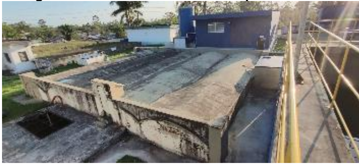
Figura 42: ETA São Defende - Tanque de contato.
