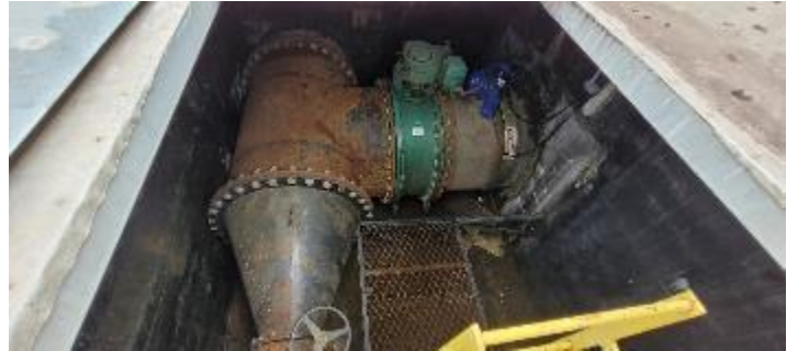
Figura 63: ETA São Defende - Reservatório Pulmão – caixa de manobras.
