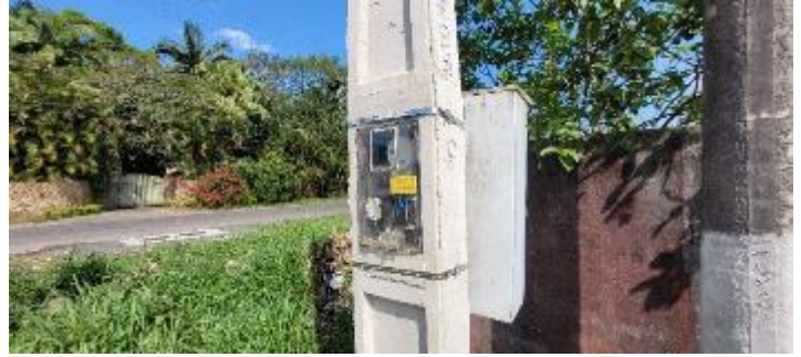
Figura 76: Macromedidor da Rua Lucas Peruchi.
