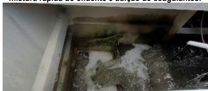
Figura 126: ETE Forquilha - Tratamento preliminar – mistura rápida do efluente e adição de coagulantes.
