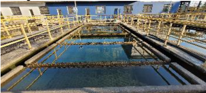
Figura 26: ETA São Defende – Decantadores.
