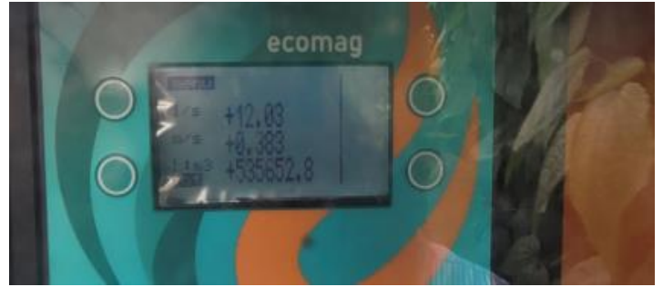
Figura 68: Macromedidor da Seara Alimentos - Av. 25 de Julho.
