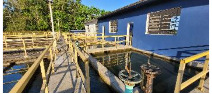
Figura 31: ETA São Defende – Filtros.
