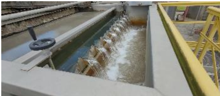
Figura 133: ETE Forquilha – Flotador - efluente clarificado.
