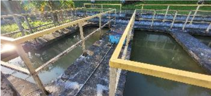
Figura 24: ETA São Defende - Floculadores mecânicos.
