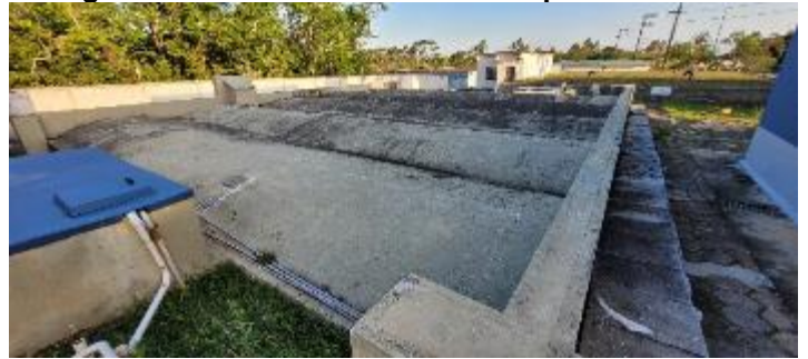
Figura 43: ETA São Defende - Tanque de contato.
