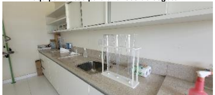
Figura 161: ETE Forquilha – Laboratório – equipamentos para análises do esgoto.
