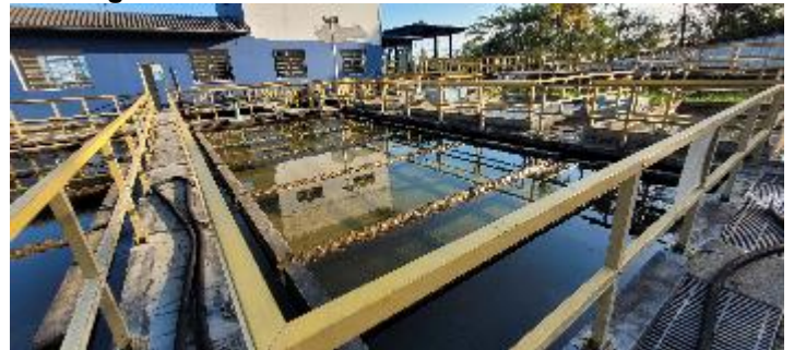
Figura 27: ETA São Defende – Decantadores.
