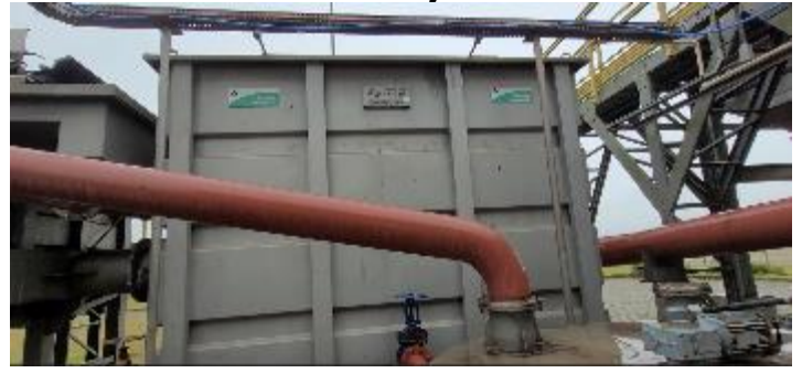
Figura 149: ETE Forquilha – flocculadores mecânicos - arranjo hidráulico.
