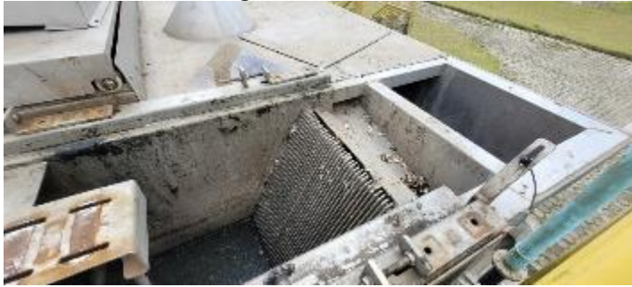
Figura 127: ETE Forquilha - Tratamento preliminar – gradeamento.
