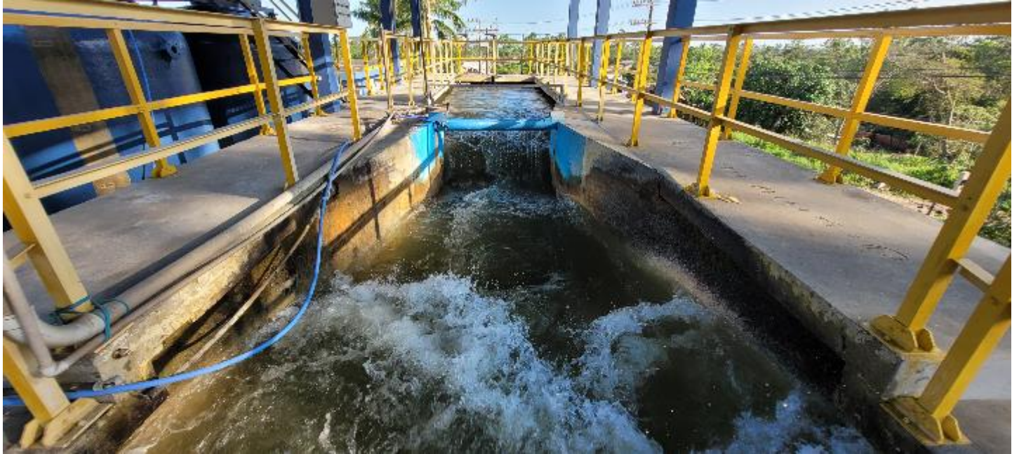
Figura 18: ETA São Defende - Calha Parshall - chegada da água bruta.
