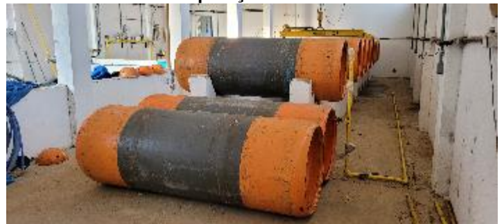
Figura 35: ETA São Defende - Casa de dosagem de cloro – disposição dos cilindros.
