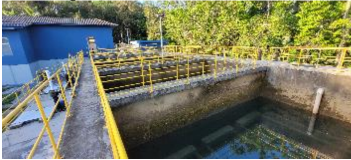
Figura 32: ETA São Defende – Filtros.
