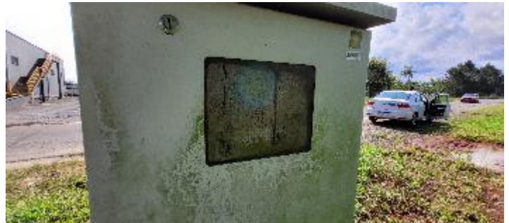
Figura 78: Macromedidor do bairro Santa Cruz – Rua Lucas Peruchi.
