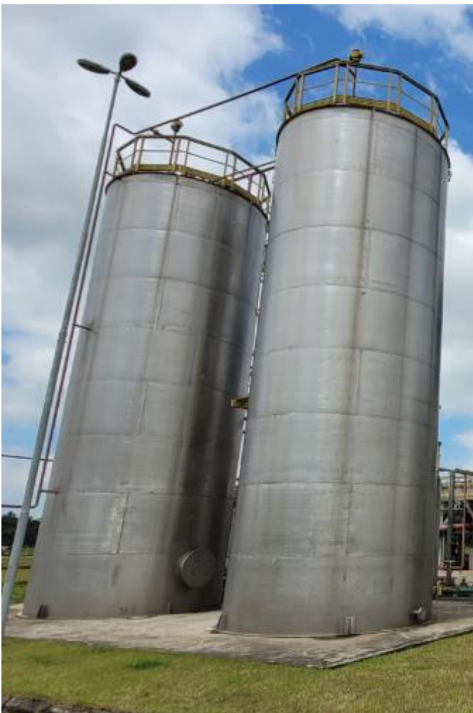
Figura 150: ETE Forquilha – Digestores de lodo.
