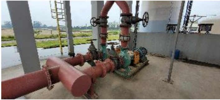
Figura 152: ETE Forquilha – arranjo hidráulico – unidades de bombeamento.
