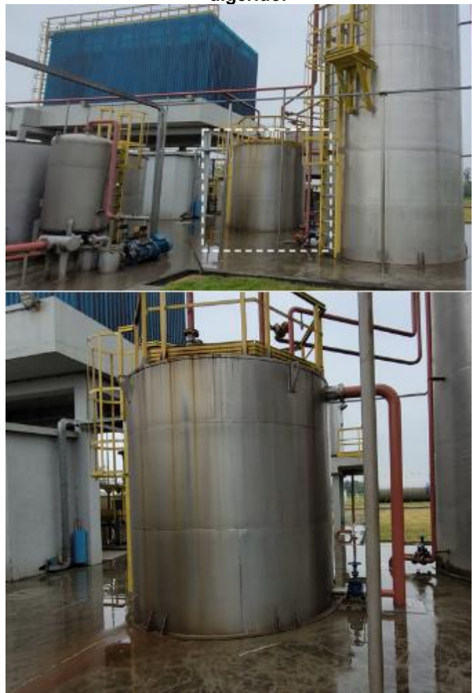
Figura 151: ETE Forquilha – Tanque de lodo digerido.
