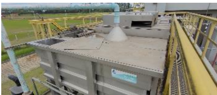
Figura 125: ETE Forquilha - Tratamento preliminar.
