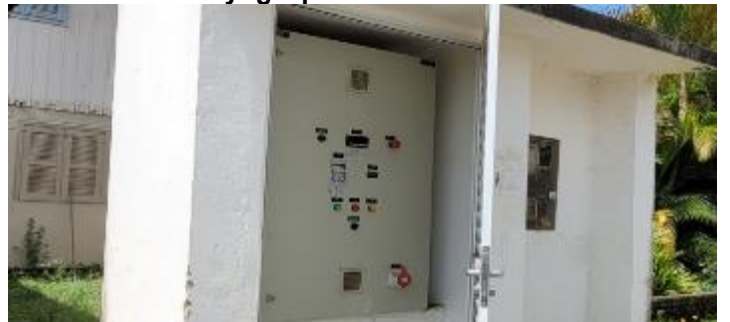
Figura 102: EEE14 Bairro Santa Ana – Rua Gabriel Eyng – painéis elétricos.
