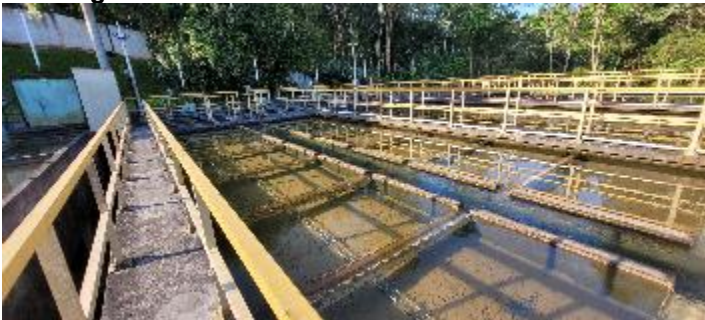
Figura 28: ETA São Defende – Decantadores.
