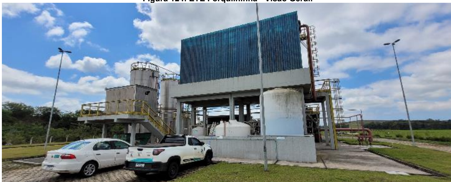
Figura 124: ETE Forquilha - Visão Geral.
