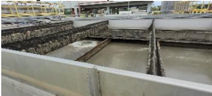
Figura 131: ETE Forquilha – Flotador.
