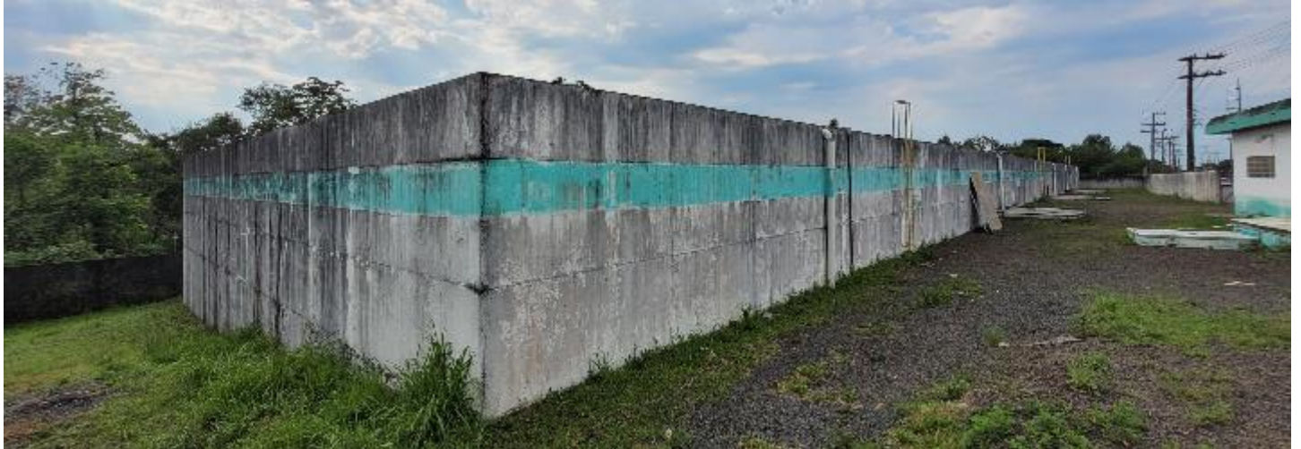
Figura 61: ETA São Defende - Reservatório Pulmão.
