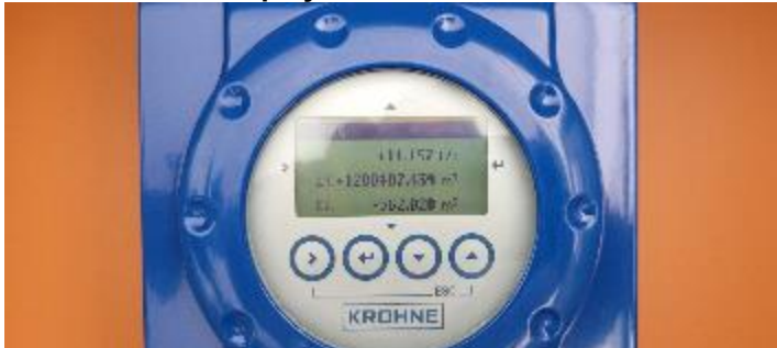
Figura 87: Booster Maracajá – Rodovia Jacob Westrup – display do Macromedidor.
