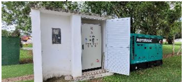
Figura 107: EEE13 Bairro Centro – Rod Jacob Westrup – painéis elétricos.
