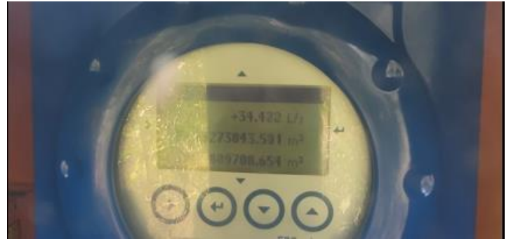
Figura 84: Macromedidor Rio Sangão – Rodovia Gabriel Arns.
