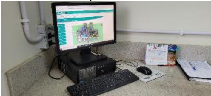
Figura 162: ETE Forquilha – Laboratório – sistema supervisorio.
