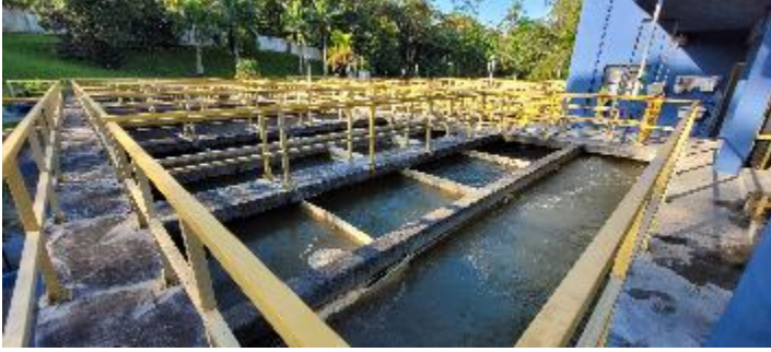
Figura 22: ETA São Defende - Floculadores hidráulicos.
