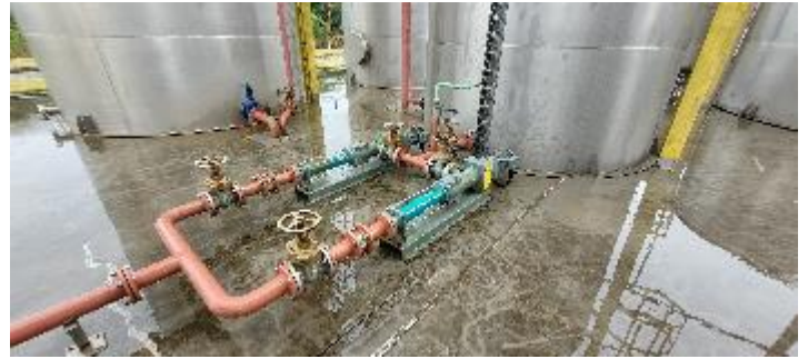
Figura 153: ETE Forquilha – arranjo hidráulico – unidades de bombeamento.
