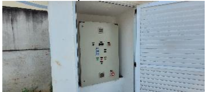
Figura 113: EEE10 – B Centro – Av. 25 de Julho – quadro elétrico.
