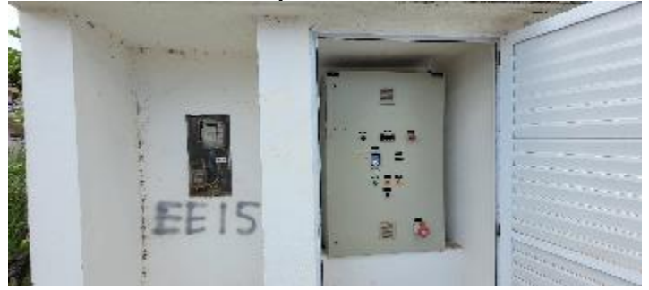
Figura 98: EEE-15 - Bairro Santa Isabel - Rua Cinquenta e Dois – painéis elétricos.
