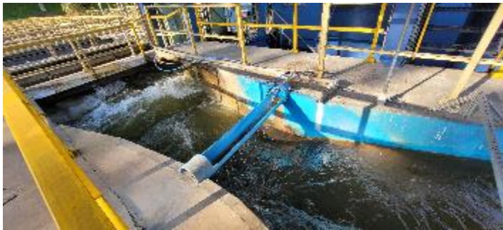
Figura 19: ETA São Defende - Adição de coagulantes.
