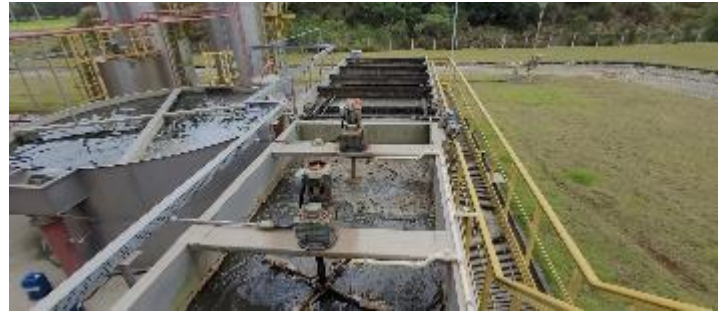
Figura 130: ETE Forquilha – Floculadores mecânicos.
