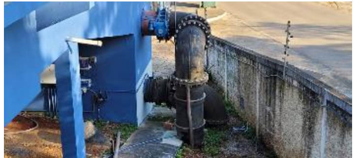
Figura 17: ETA São Defende - Chegada das adutoras de 600 e 800 mm.
