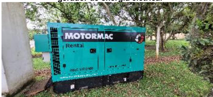
Figura 108: EEE13 Bairro Centro – Rod Jacob Westrup – gerador de energia elétrica.
